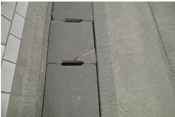
공동구 SPAN.48 덮개 파손
