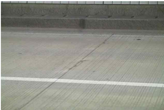
포장부 SPAN.76 파손
