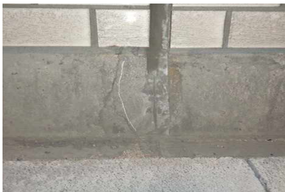
측벽부 SPAN.13 균열(0.3mm 이상)
