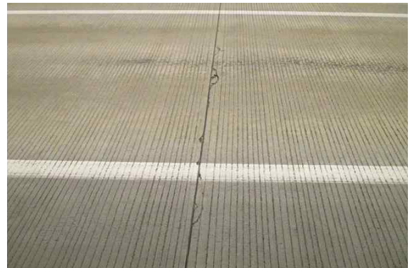
포장부 SPAN.96 파손
