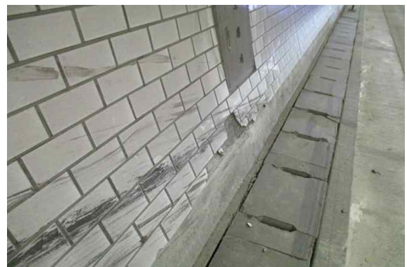
측벽부 SPAN.76 타일파손
