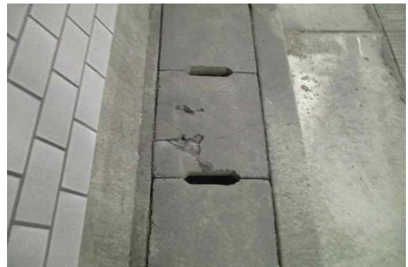
공동구 SPAN.74 덮개 파손
