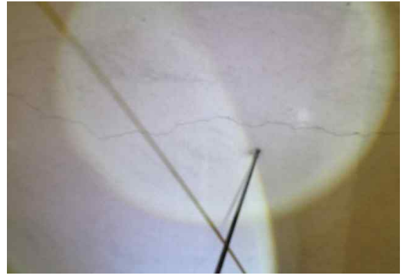
라이닝 SPAN.36 균열(0.3mm 이상)
