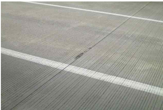
포장부 SPAN.66 파손
