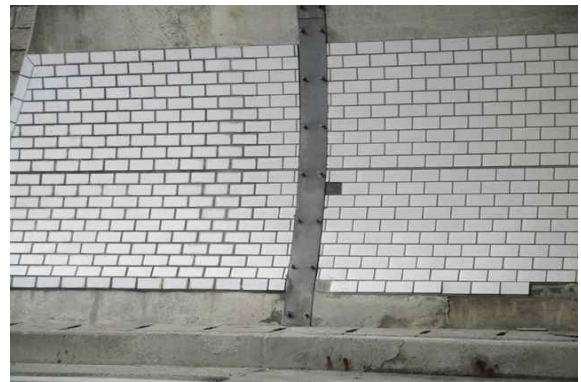
측벽부 SPAN.1 타일탈락
