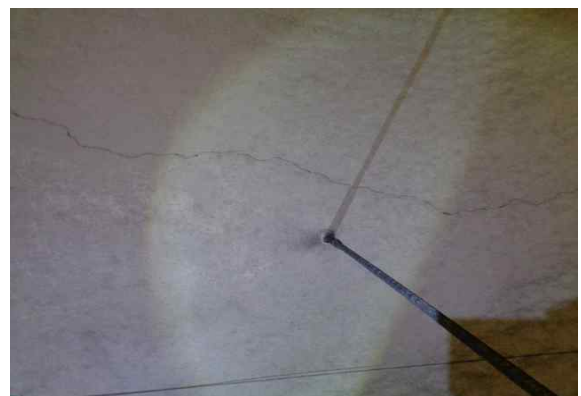
라이닝 SPAN.89 균열(0.3mm 이상)
