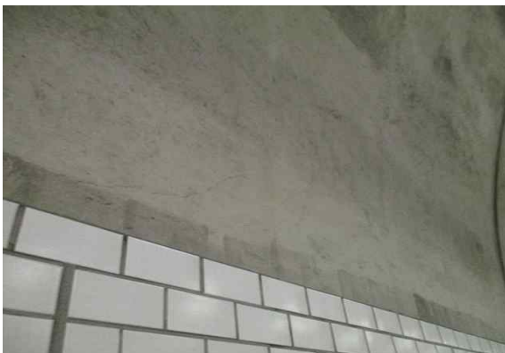
라이닝 SPAN.62 균열(0.3mm 미만)
