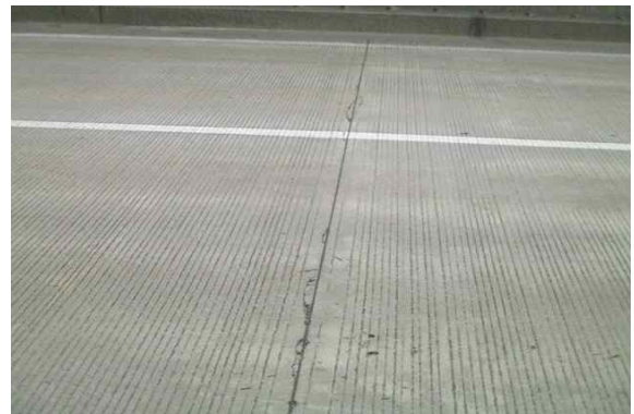
포장부 SPAN.73 파손
