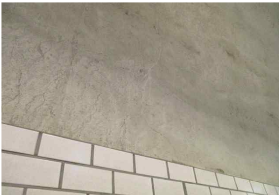
라이닝 SPAN.26 균열(0.3mm 미만)
