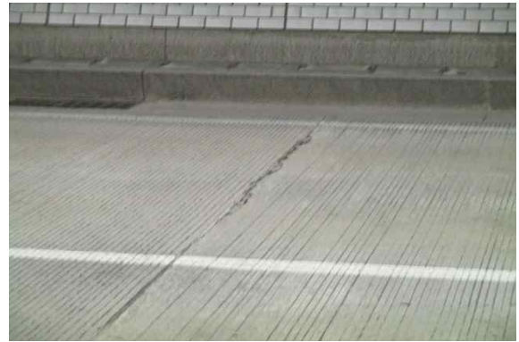
포장부 SPAN.58 파손
