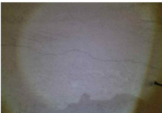
라이닝 SPAN.89 균열(0.3mm 이상)
