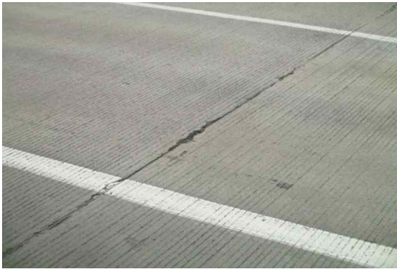
포장부 SPAN.58 파손
