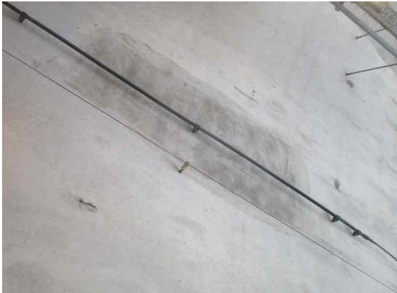
라이닝 SPAN.3 천단부 철근노출 보수현황
